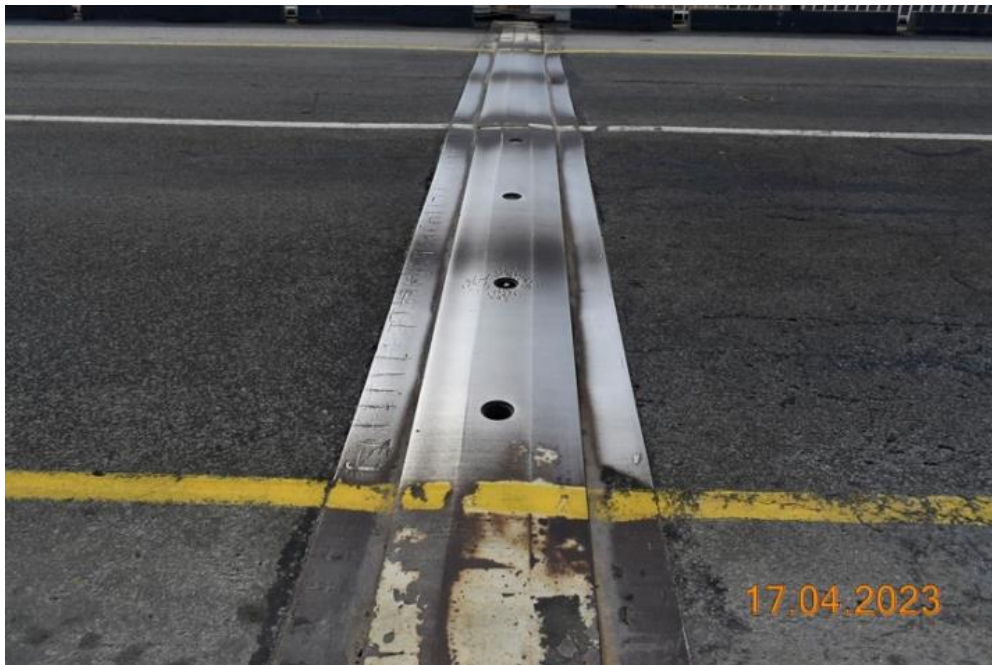
Рисунок 2. Дефект №311 (17.04.2023). Расстройство конструкции перекрывающего элемента. Деформационный шов №24 (Перекрытый). Над опорой №25. Левая полоса проезда. Отсутствуют крышки прижимного устройства
