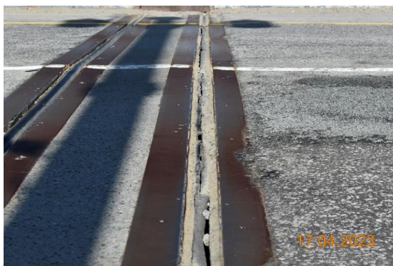
Рисунок 1. Дефект №301 (17.04.2023). Расстройство полимерного компенсирующего профиля. Деформационный шов №7 (с полимерным компенсирующим профилем). Над опорой №8, между разделительной стенкой ригеля опоры №8 и ПС№8. По всей длине шва. Разрыв резинового компенсатора
