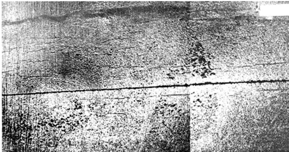
Рисунок 4. Прямолинейная стресс-коррозионная трещина, инициированная протяженной царапиной поверхности трубы диаметром 1420 мм производства ХТЗ
